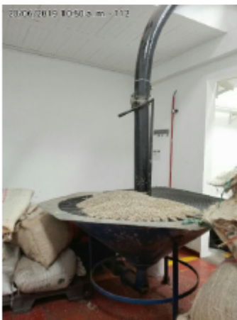
Fotografía No. 5 Tolva de precalentamiento
